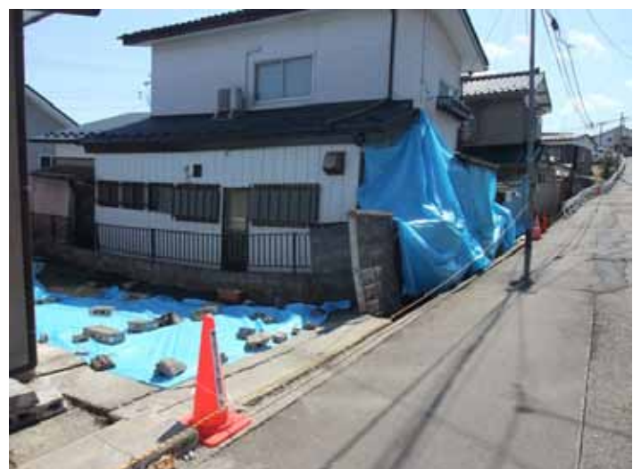
写真3 仙台市太白区緑ヶ丘における宅地地盤の変状と家屋被害 (地滑り防止杭が盛土全体のすべりを防いだものの、杭が押されて、宅地地盤が少し変形したことにより、家屋が被災した。)
