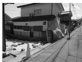
写真3 仙台市太白区緑ヶ丘における宅地地盤の変状と家屋被害
