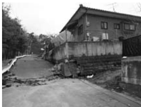
写真2 仙台市青葉区折立における造成宅地盛土の被害
